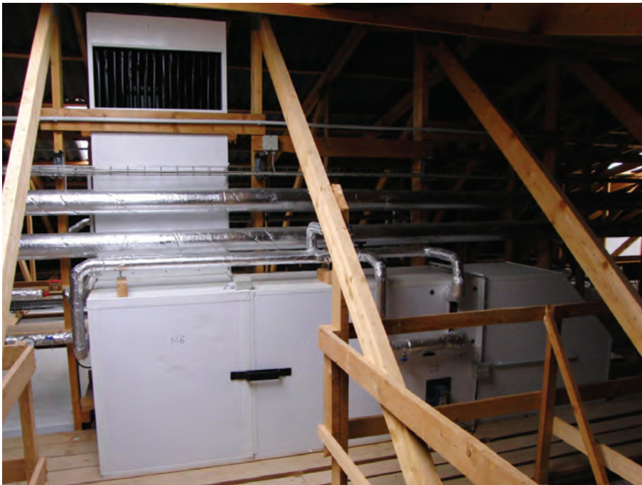
Abb. 1: Wärmetauscher im Stalldachgeschoss
